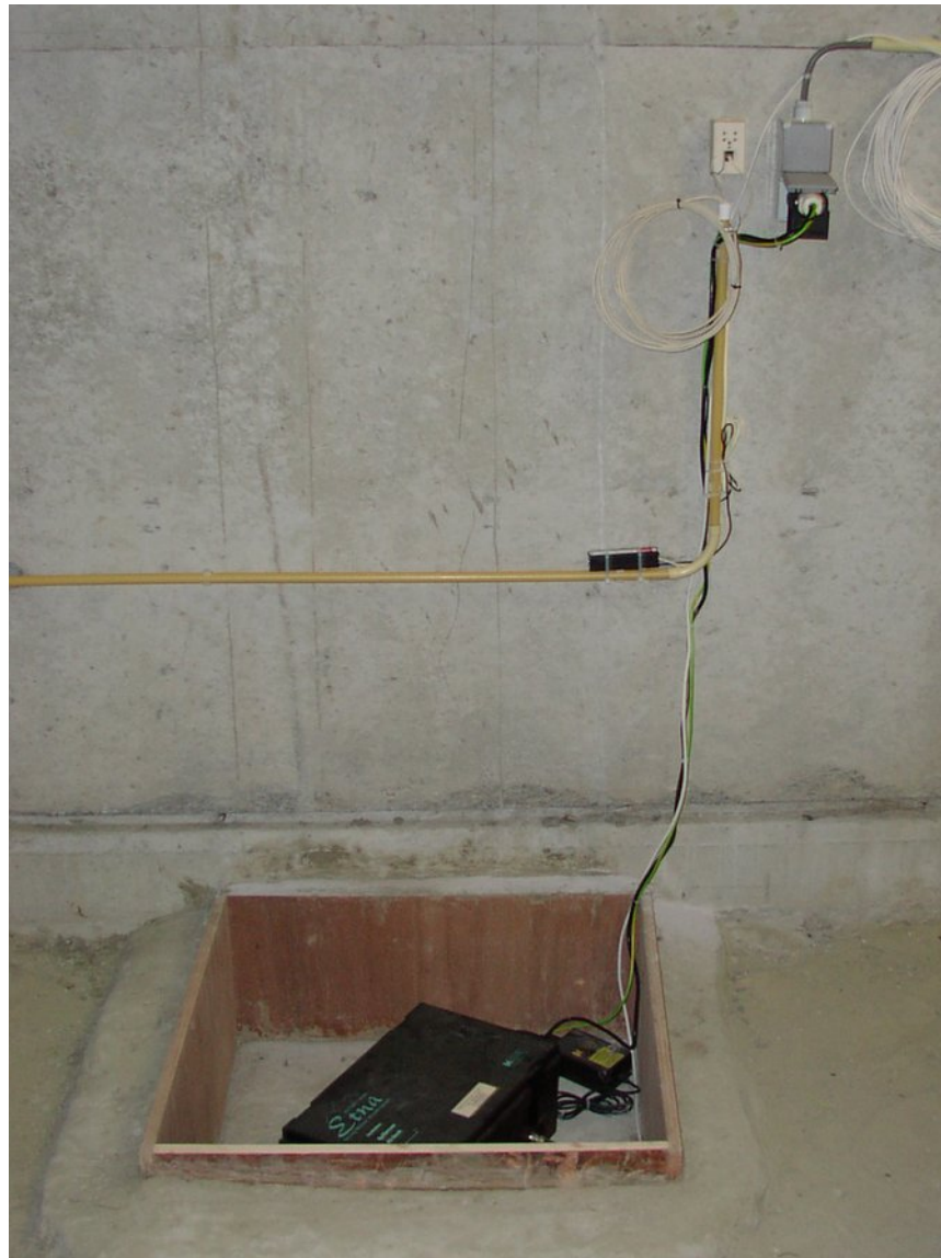
Accelerometer station Station accélérométrique à Strépy-Thieu
